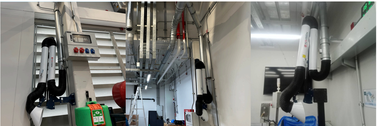
Customer : GPV Asia (Thailand) Co., Ltd. งานวางระบบและติดตั้งแขนดูดอากาศ Extraction Arms
