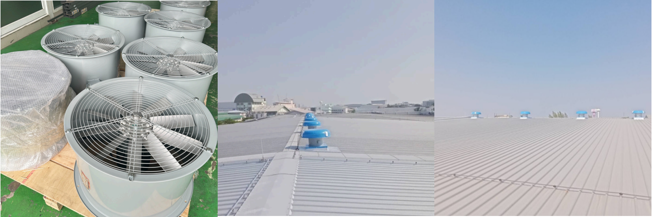
Customer : GPV Asia (Thailand) Co., Ltd. งานออกแบบและติดตั้งพัดลมระบายอากาศ Exhaust Fan
