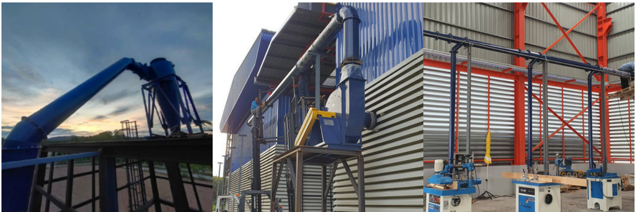
งานออกแบบและติดตั้งระบบบำบัดอากาศ Duct Line System & Blower
